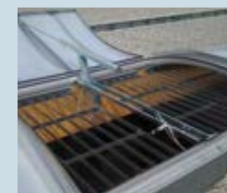
Griglia in acciaio fissata sul basamento della fascia luminosa
